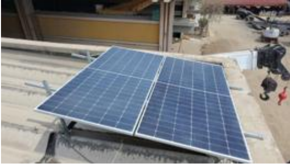
Ilustración 81. Plan Piloto energía alternativa – instalación paneles solares Taller Electricidad Mamonal
