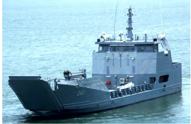
Ilustración 37. Trabajos de Cambio de láminas de acero y pintura del casco ARC "Golfo de Tribugá"
