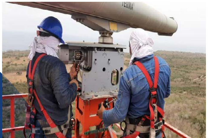
Ilustración 41 - Mantenimiento del Sistema de control de tráfico y vigilancia marítima Guardacostas ARC
