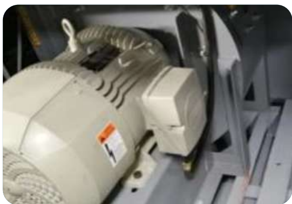
Unidades de ventilación
